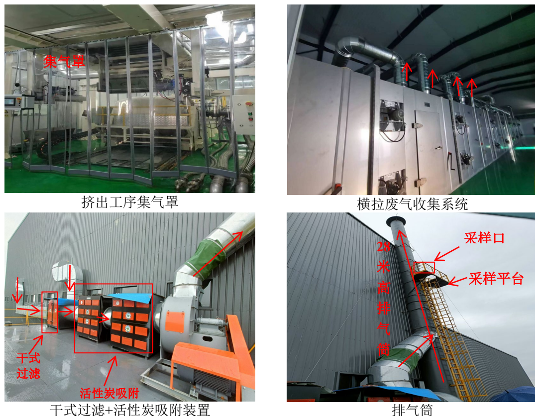
图 4.1-1 废气治理措施实际建设情况
