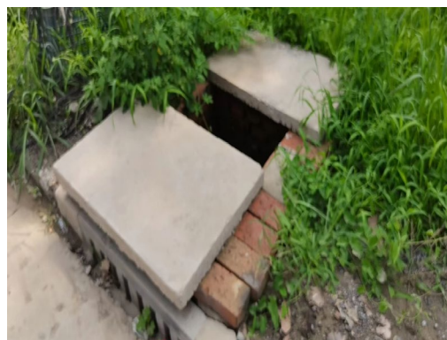
废水总排放口
